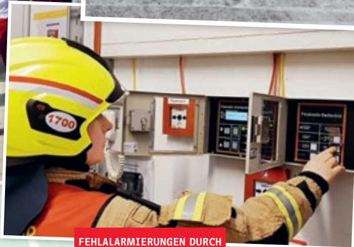
FEHLALARMIERUNGEN DURCH BRANDMELDEANLAGEN
